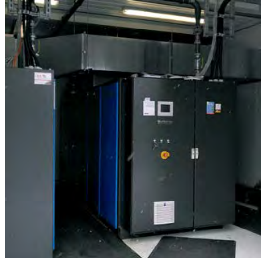
Zwei Buderus-BHKW-Module beliefern den POLYTEC-Standort Altenstadt verlässlich mit sauberer und günstiger Energie.
